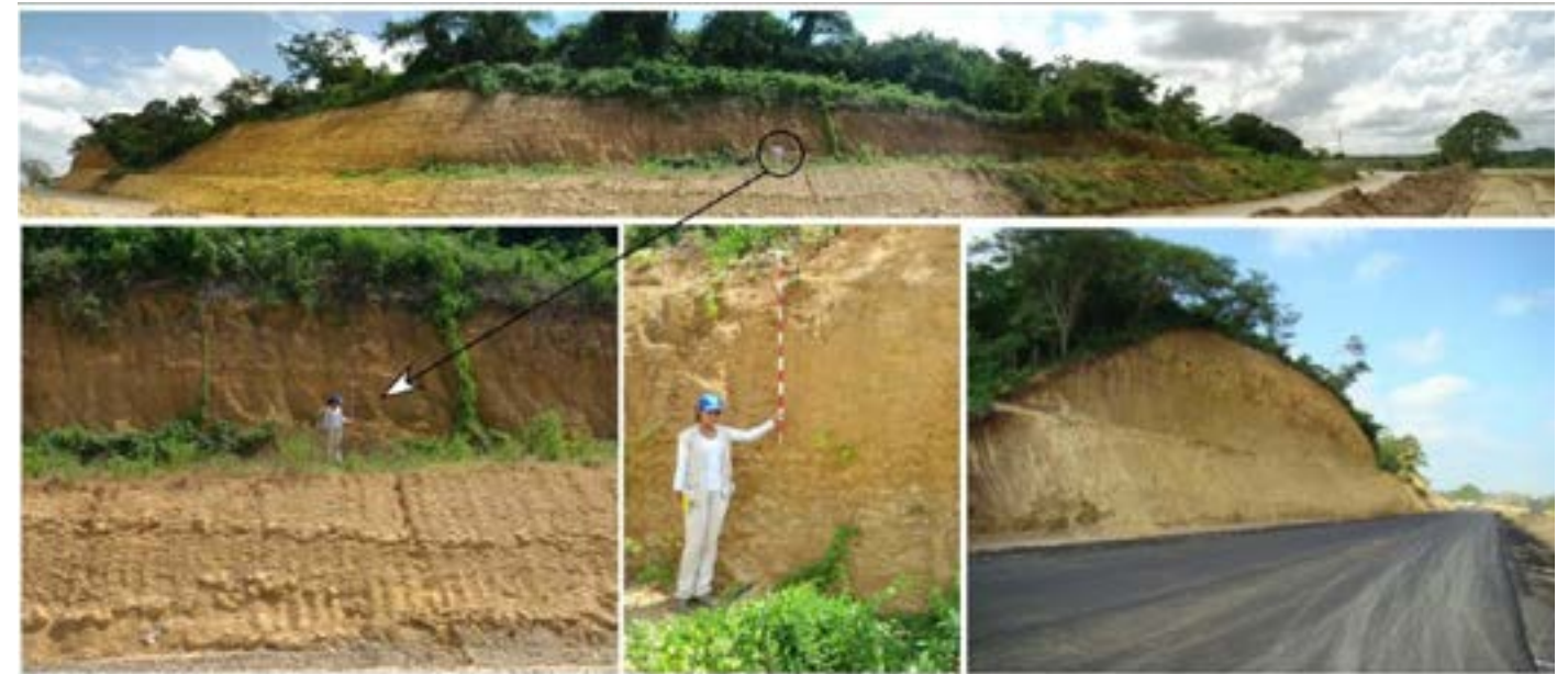
Figura 210. Panorámica de una sección de la formación Tubará Cerca a la Subestación eléctrica de Sabanalarga.
